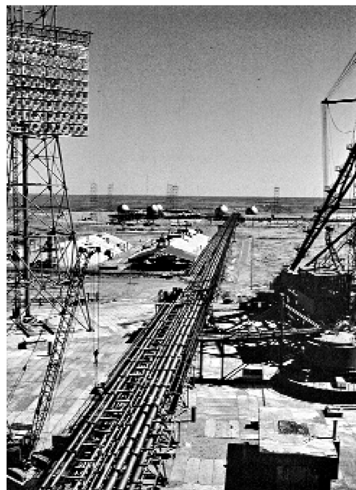
Байконур, заправочный трубопровод для комплекса «Энергия-Буран»
